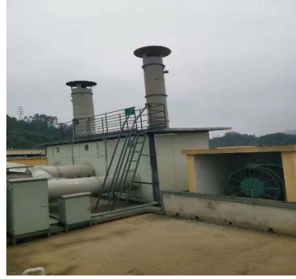
油墨废气和电解液废气排气筒
