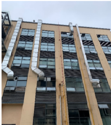
3C 厂房的 3 根天然气排气筒
