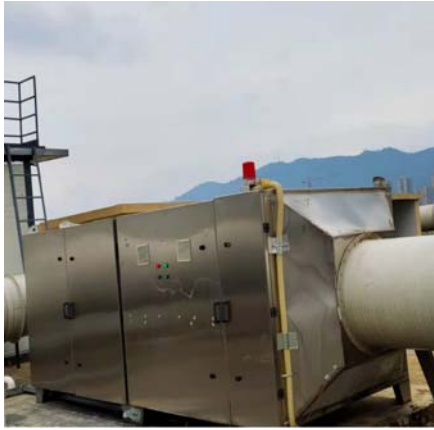
电解液废气处理系统
