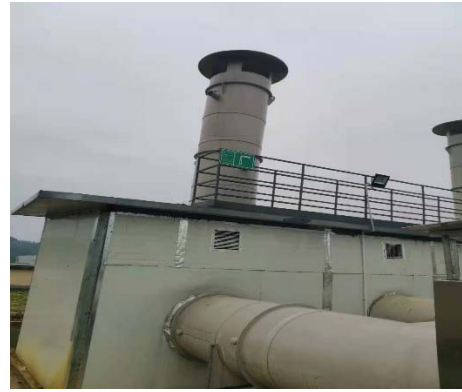
电解液废气排气筒
