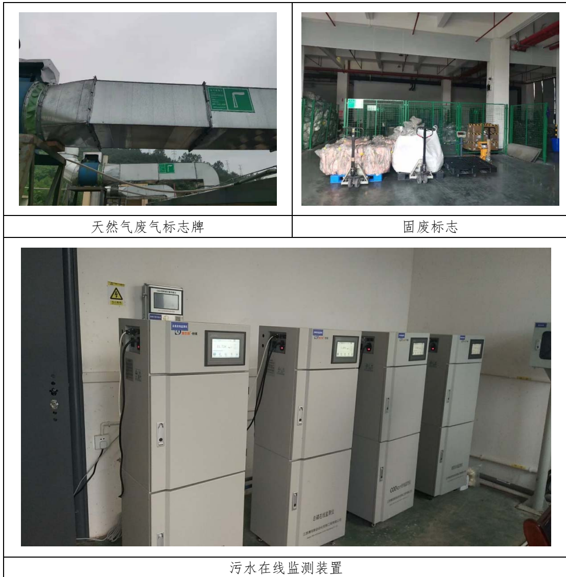
图 4.1-10 项目规范化排污口、监测设施装置现场图片
