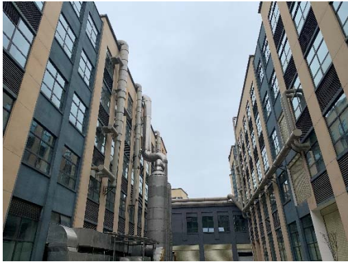
3A 与 3B 间废气外墙收集管线
