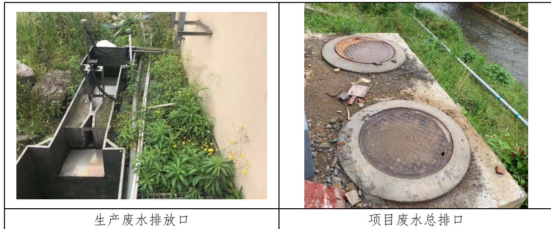
图 4.1-7 项目废水治理现场图片
