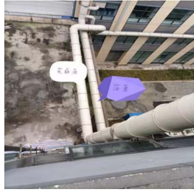
3A 与 3B 间废气外墙收集管线
