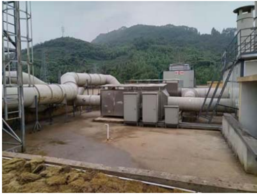
油墨废气处理设施
